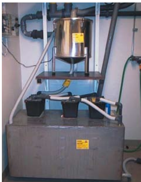
I bufferttanken under en centralsugsanläggning kan stora mängder amalgam samlas i de fall systemet är eller har varit felaktigt installerad.
