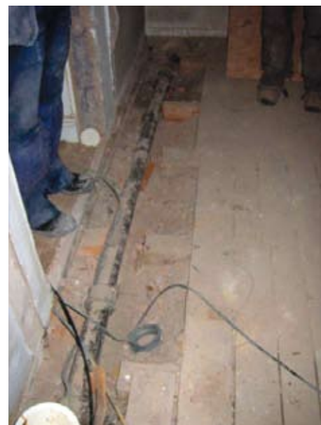
Detta gjutjärnsrör som ligger i träbjälklag har varit använt av en tandläkare och är med stor sannolikhet kontaminerat med kvicksilver.
